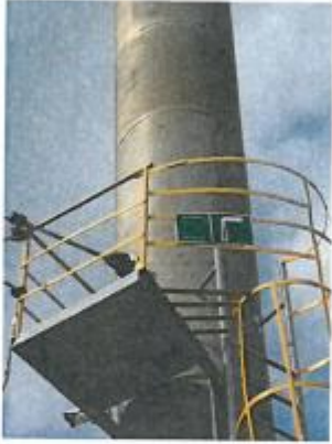
锅炉废气(处理后)排放口 (DA024)
